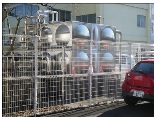
【学校の受水槽】
