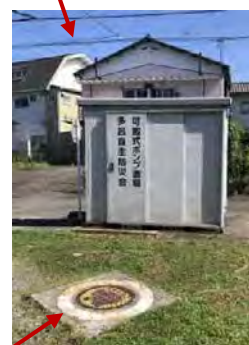
⑤ 耐震性防火水槽
