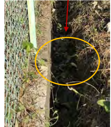
用水路壁面より水が噴出
