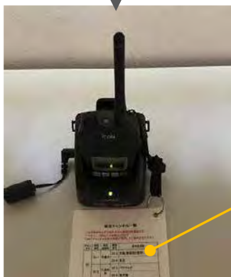
簡易無線機： 公民館 2 階ホール 正面キャビネット上
