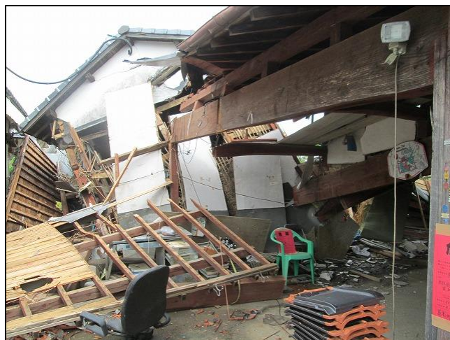
【平成 28 年熊本地震の被災の様子】
