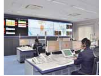
▲消防通信指令センター
