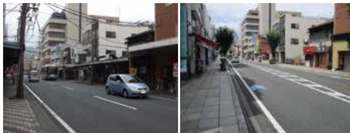
▲無電柱化した(主)三島停車場線(芝町工区) ※左:施工前、右:施工後
