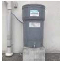
雨水貯留施設
