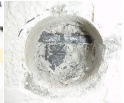
(腐食グレード)
