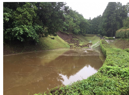
三ノ丸被災後（7月6日、南から撮影）
