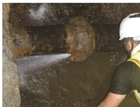
図 2-6 老朽化した管路継手からの漏水
