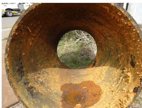
図 2-5 老朽化した管路内面の錆
