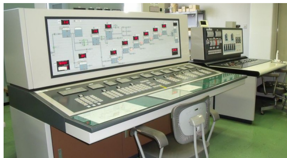
図 3-1 伊豆島田浄水場 中央監視装置
