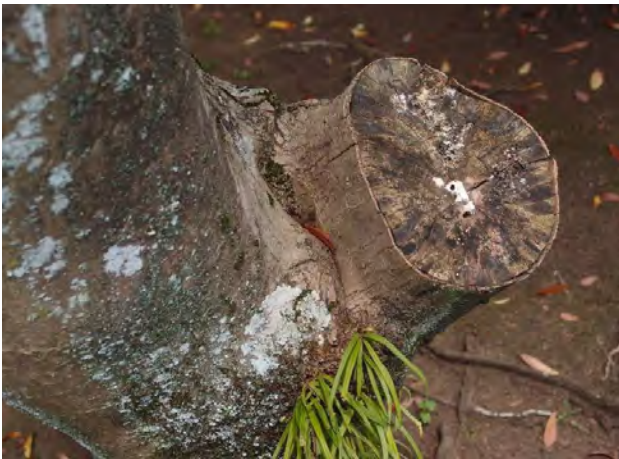
↑ No 243 イロハモミジ (枝切除痕の腐朽)
