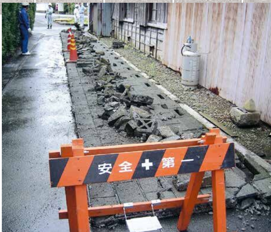
駿河湾を震源とする地震（平成21年8月11日発生）によるブロック塀の倒壊
