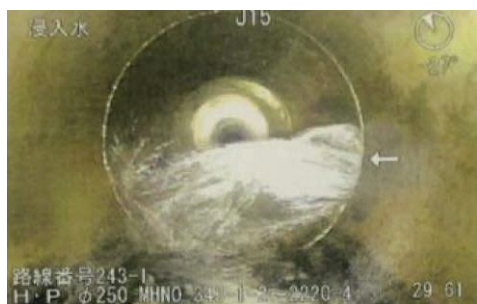
改築実施前（不明水が右側から侵入）
