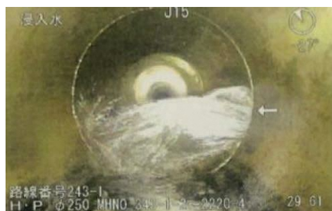
改築実施前（不明水が右側から侵入）
