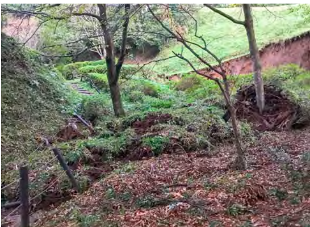
图 9-8 令和元年被災 7 A 田尻の池上側
