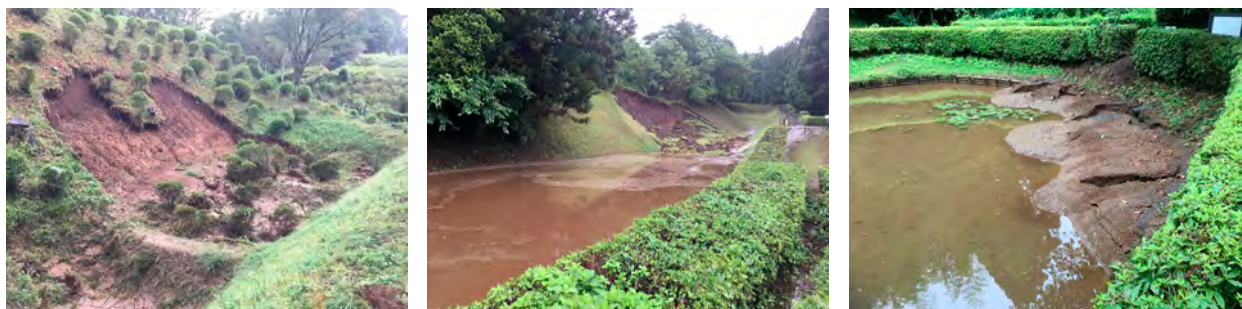
図7-3 被災状況（左から 西ノ丸障子堀、三ノ丸堀、土砂の流入した田尻の池）
