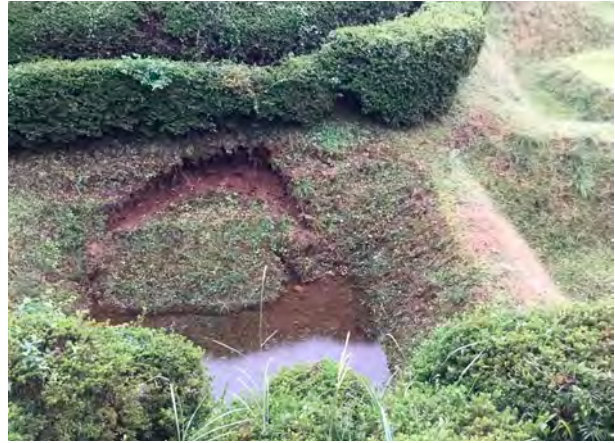
图 9-5 令和元年被災 4 西ノ丸北堀
