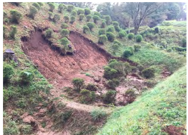
図 9-3 令和元年被災 2 西ノ丸南堀
