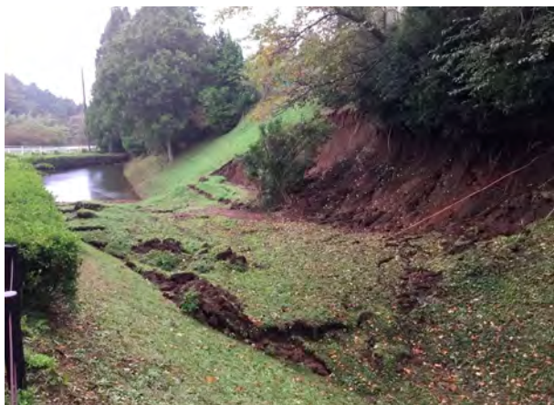
図 9-2 令和元年被災 1 三ノ丸西堀
