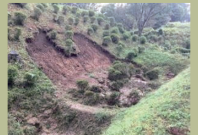
山中城跡*1の障子堀の崩落
