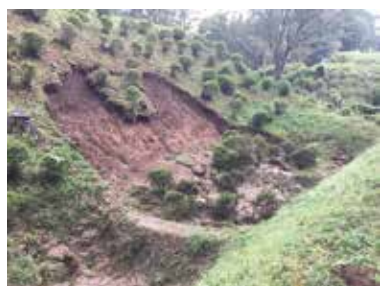
山中城跡の障子堀の崩落
