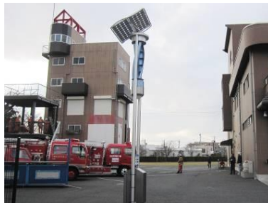
消防庁舎の ハイブリッド外灯
