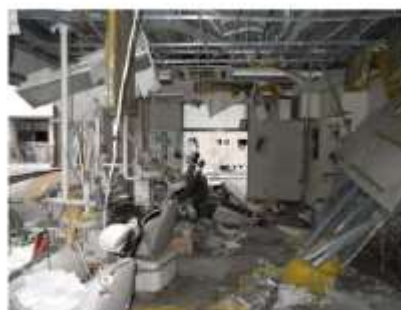
被災建築物内側
