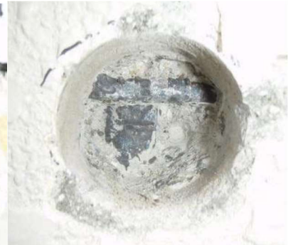
(腐食グレード)
