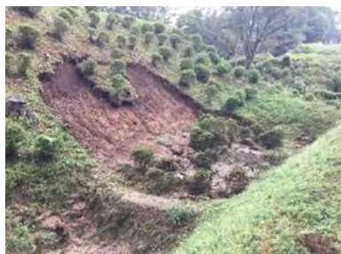
山中城の障子堀の崩落
